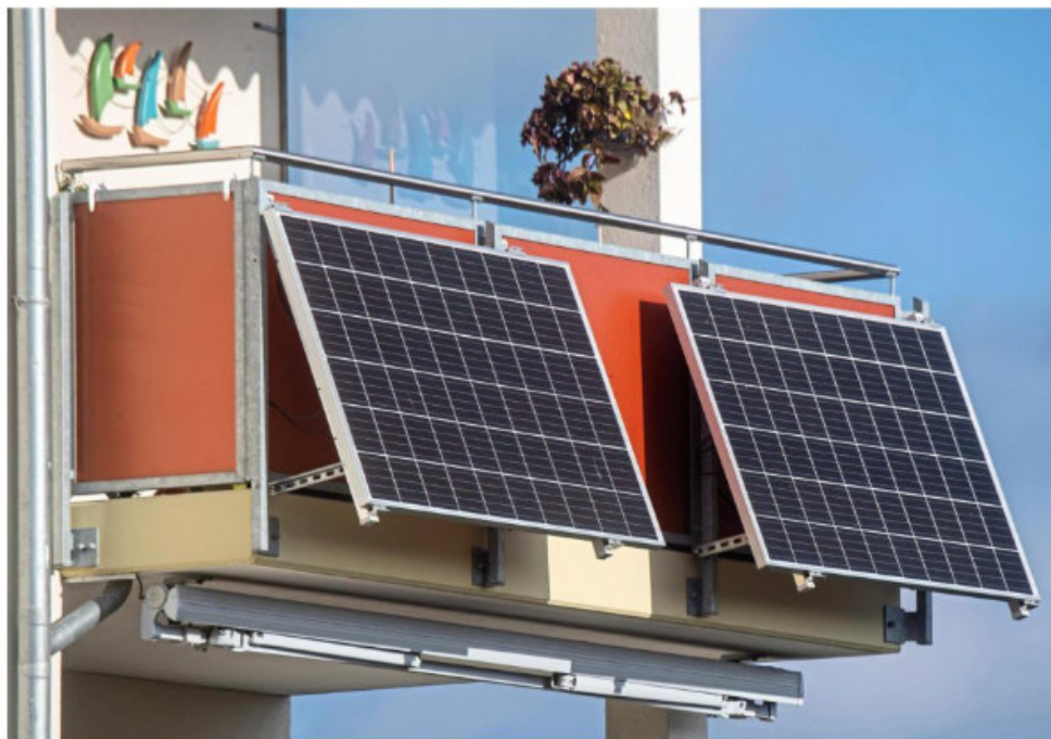
Solarmodule für ein sogenanntes Balkonkraftwerk hängen an einem Balkon. Immer mehr Hausbesitzer und Wohnungsinhaber installieren solche Anlagen zur Stromgewinnung. Foto: Stefan Sauer/dpa
